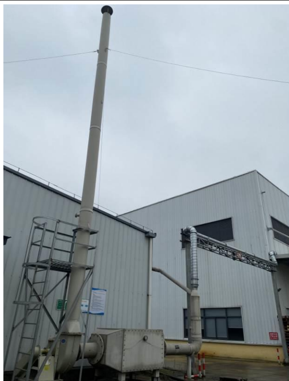
危废仓库、实验室等废气排放口（DA006）
