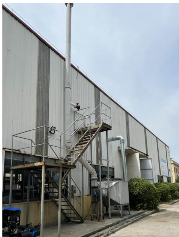
分散体车间投配料、高速分散、调和等废气 排放口（DA005）
