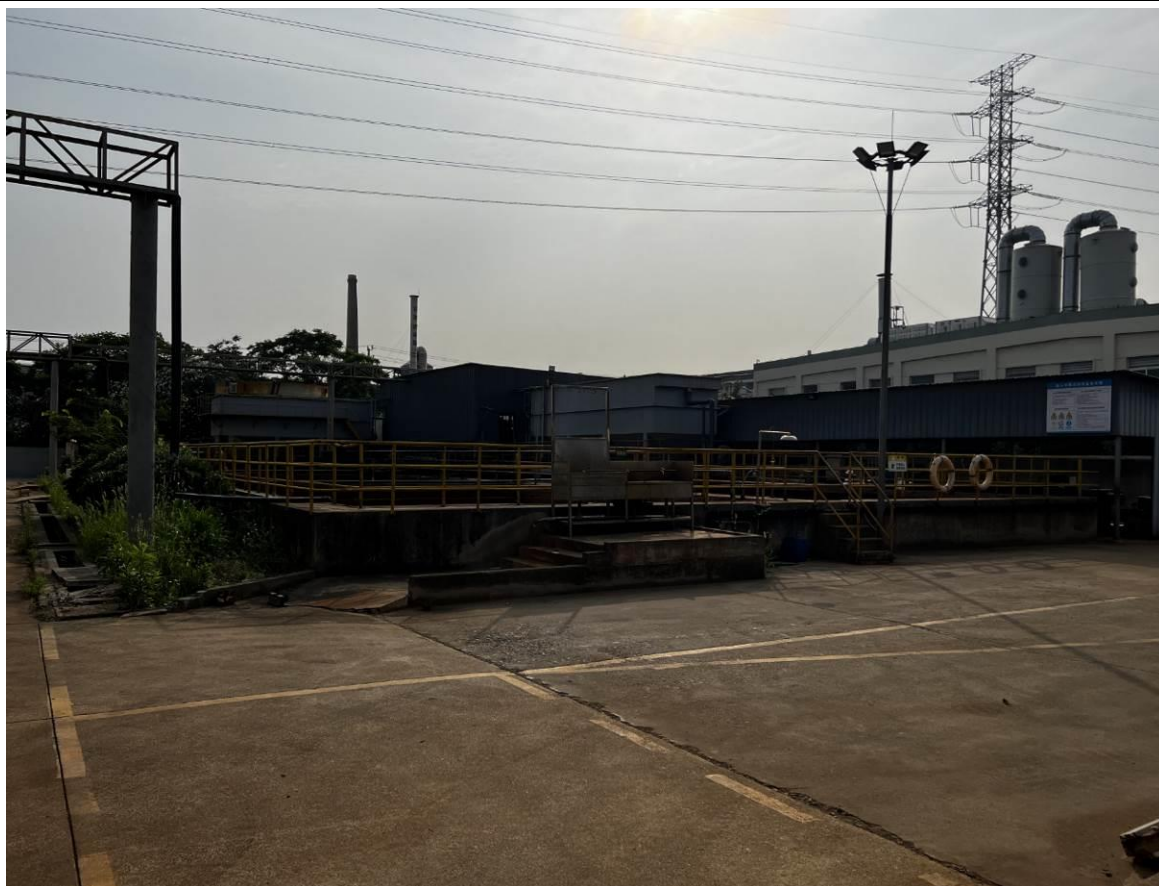
废水综合处理设施（污水站）
