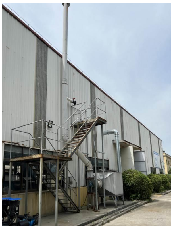
分散体车间投配料、高速分散、调和等 废气处理设施
