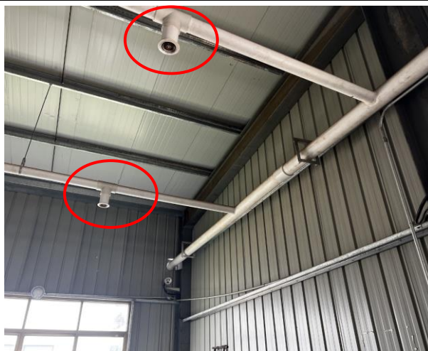
危废仓库废气：多点位集气罩+车间整体抽气
