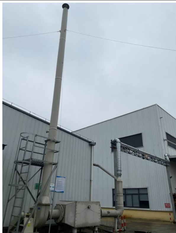
危废仓库、实验室等废气处理设施
