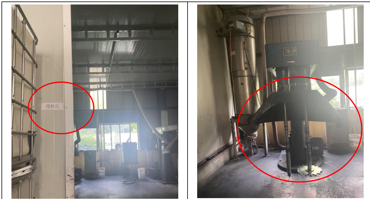
功能性纳米有机颜料分散体--投配料粉尘：投料隔间+集气罩收集
