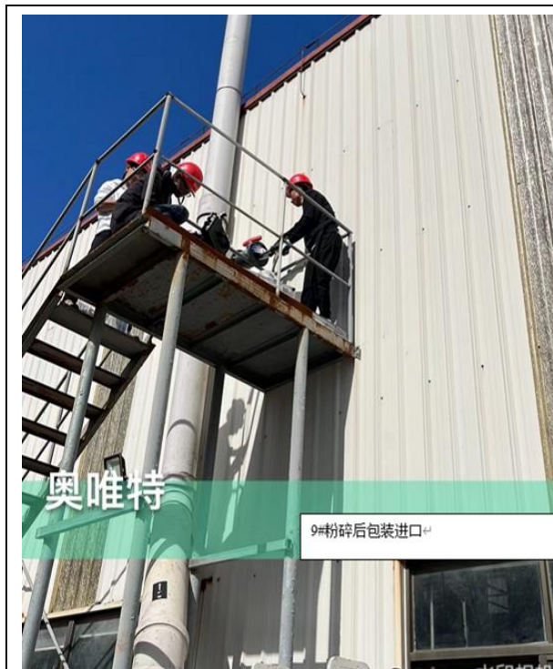
9#: 粉碎后包装废气处理设施进口
