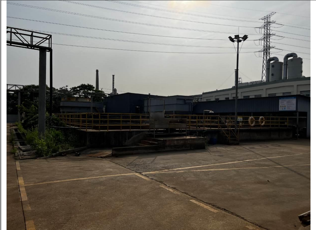
废水综合处理设施（污水站）
