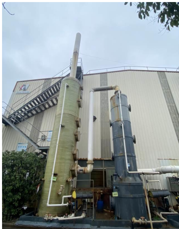
硫酸亚铁制备硫酸雾废气排放口（DA001）
