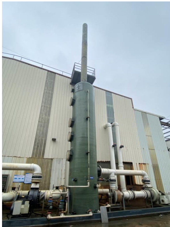
硫酸高铁、胶体制备硫酸雾废气排放口 （DA002）
