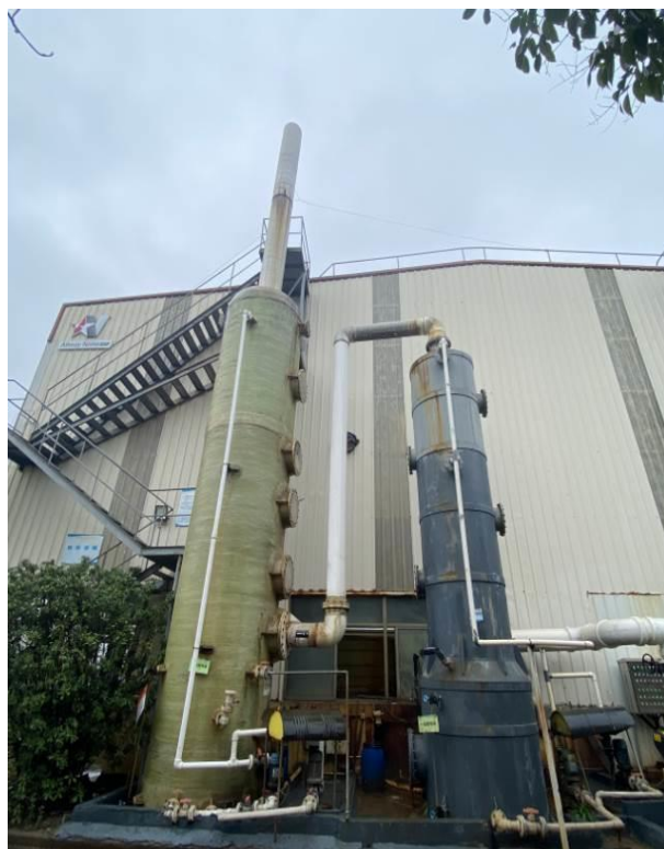
硫酸亚铁制备硫酸雾废气处理设施
