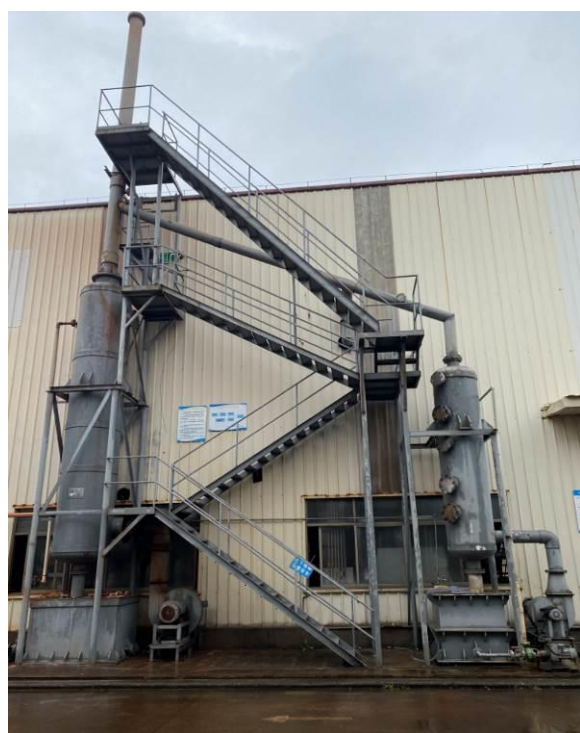
闪蒸干燥、粉碎、粉碎后包装粉尘等废气排放口（DA004）
