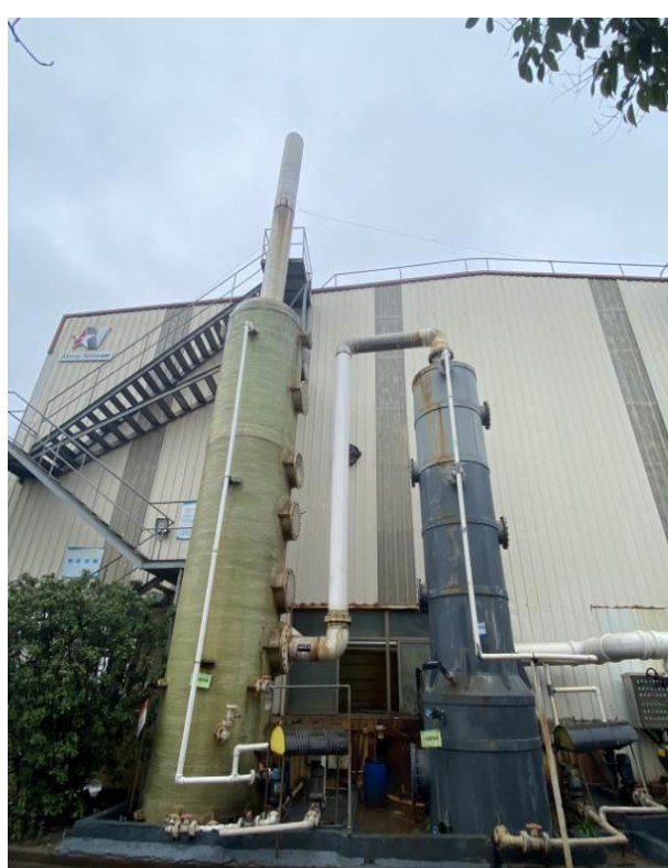
硫酸亚铁制备硫酸雾废气处理设施
